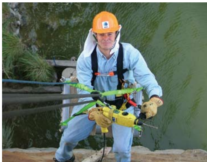
Preparando instalación del sistema de monitoreo. Serge Tamari
